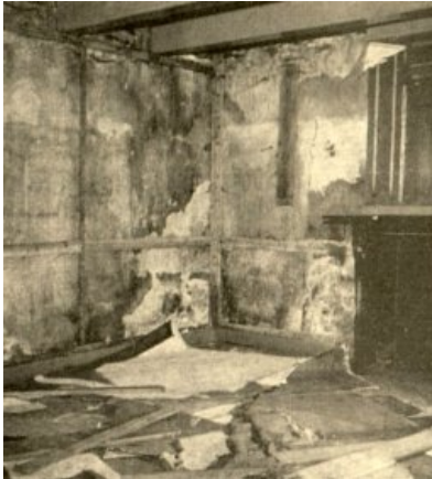
Een kamer in een van de huizen, die aan de vernielzicht van de jeugd blootstaat. Behang, planken en scherven liggen over de vloer.
